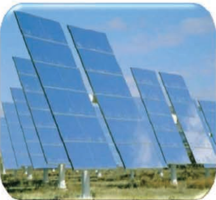
الصورة (١٨) الطاقة الشمسية
