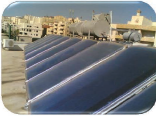
الصورة (١٧) الطاقة الشمسية
