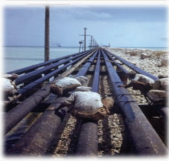
الصورة (١٢) أنابيب نقل النفط
